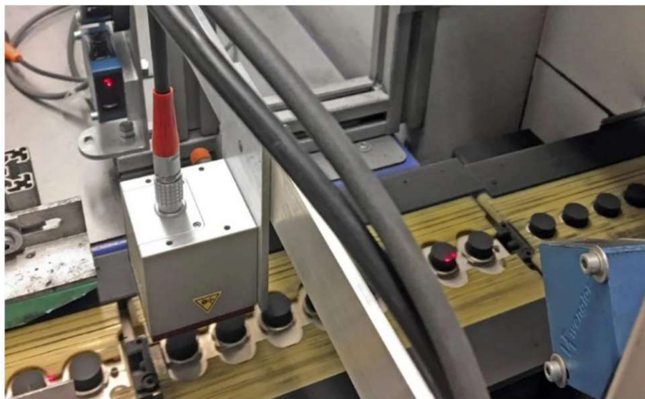
Installationen av den mindre Cube-sensorn över bandet med de målade täcklocken.
